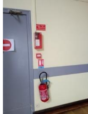
Extincteurs salle et l'alarme incendie
